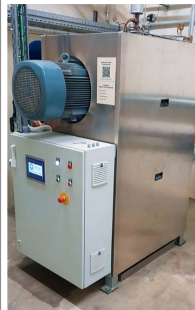
Eine Nachverstromungsanlage der AWN
